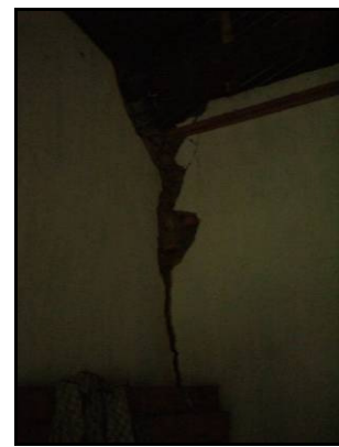
(d) Separation at the corner of walls
