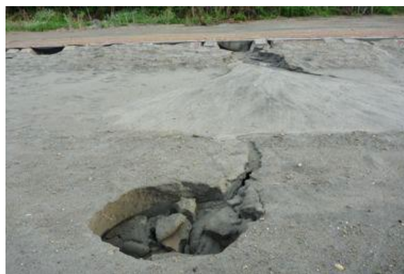
写真 5.3 長期間の降雨で陥没したエコ・コースト事業地
