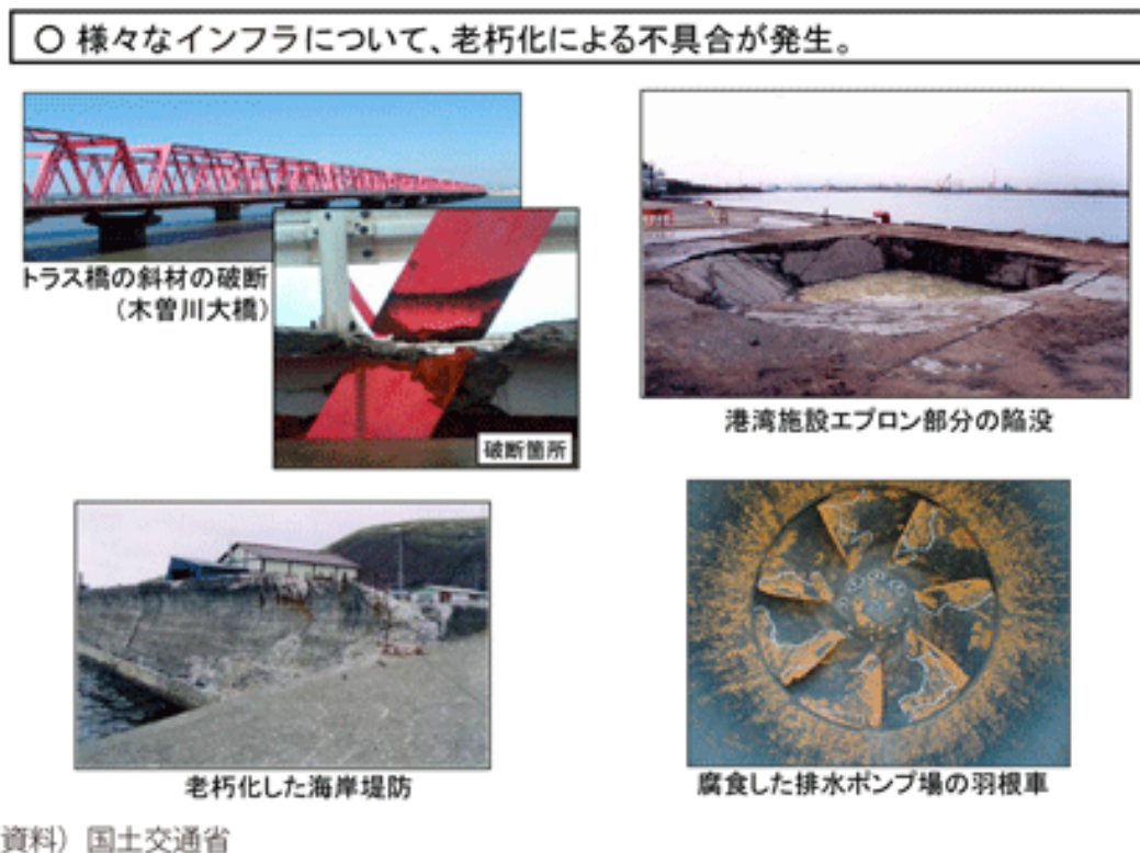
図 1.2: 老朽化したインフラ設備 [5]
